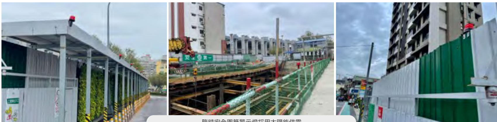
臨時安全圍籬警示燈採用太陽能供電
