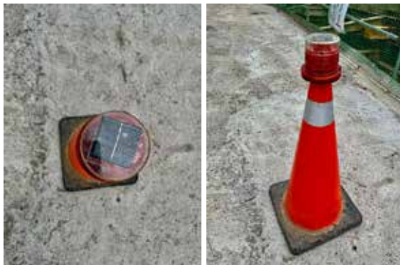
警示燈改採太陽能供電，以減少電池用量或電線拉設
