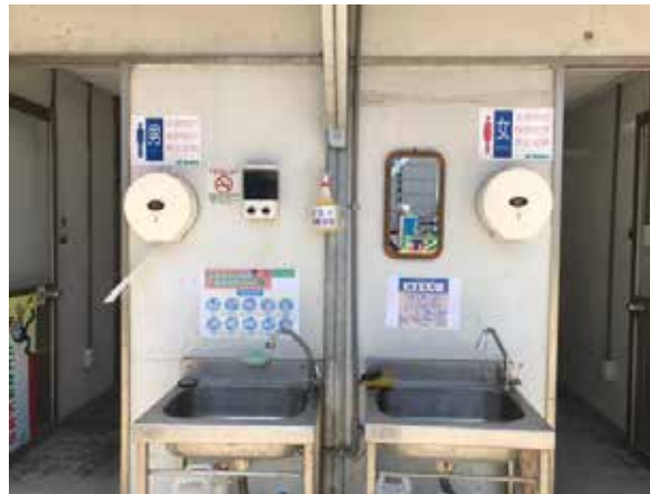
▲ 洗手台設置消毒設備
