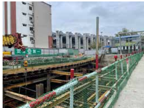
臨時安全圍籬警示燈採用太陽能供電
